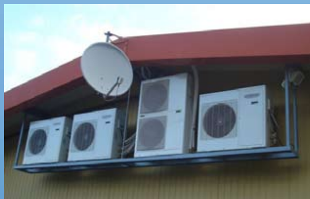
Mehrere gemischte Ausseneinheiten einer Montage unserer Monteure Plusieurs différentes unités extérieures d'une montage de nos monteures
