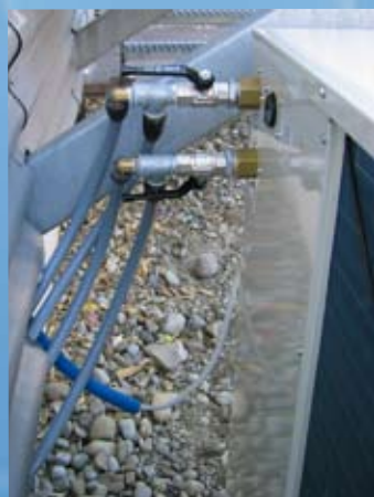
Anschlüsse mit Wasserschläuchen
