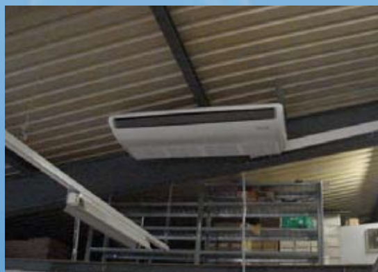
Kühlung einer Druckerei mit Deckengerät PMC 50 Climatisation d'une imprimerie avec Type PMC 50
